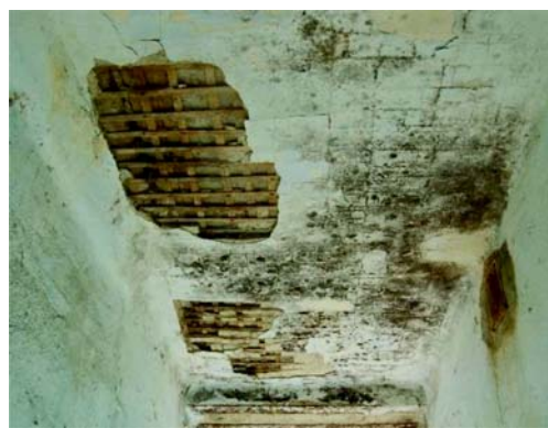
Рис. 1. Повреждения деревянных перекрытий, стен, балконов
